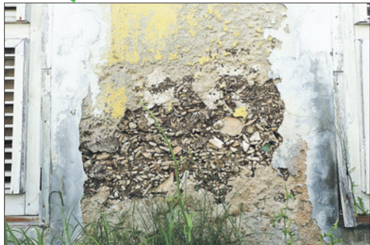
Historisch pand in Pietermaai waar het pleisterwerk is afgevallen en de originele bouwstenen blootliggen.
